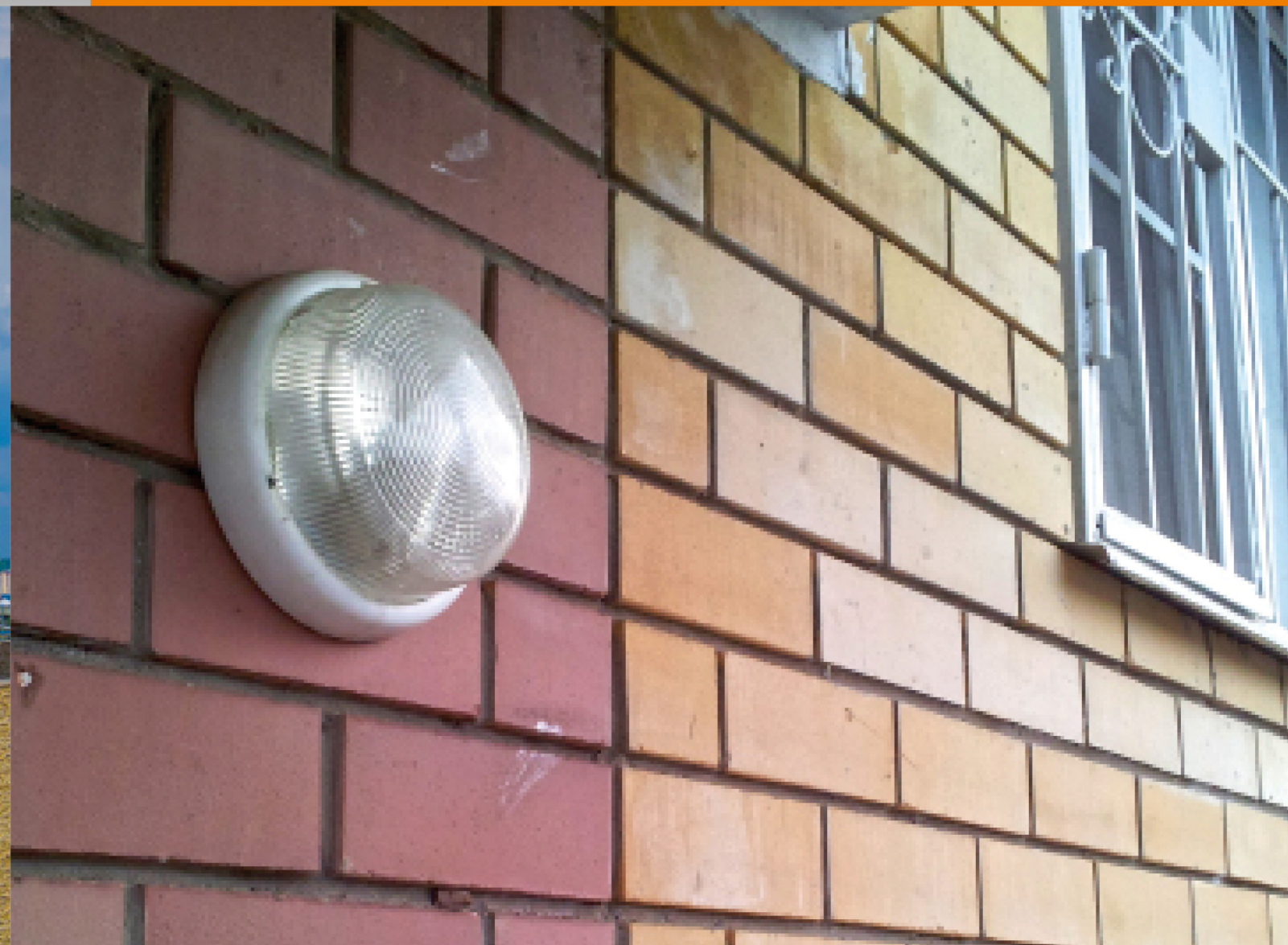
Освещение входной группы жилого комплекса г. Королёв
