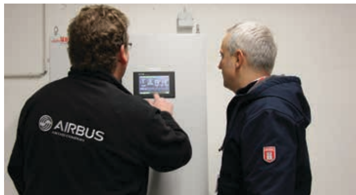
Коммутационное устройство BreakerVisu от Eaton собирает все данные от автоматических выключателей, диагностической системы для измерения температуры и от системы защиты от электродуги Arccon и связывается через Modbus напрямую с системой управления зданием
