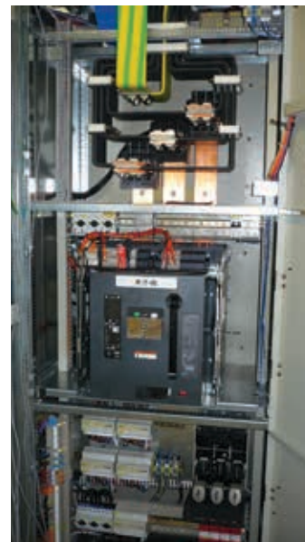
Используются автоматические выключатели IZM Eaton, оснащенные электронным расцепителем и встроенной функцией измерения.
