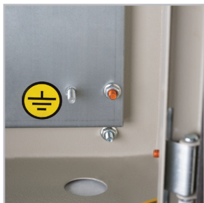
Шпилька заземления на монтажной панели.
