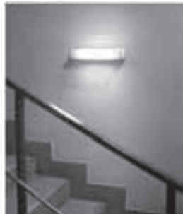
аварийное освещение путей эвакуации
