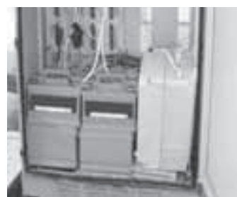
Установка в шкафу управления
